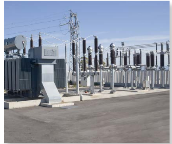
变电站电力转换 - HVDC 和 STATCOM 系统
