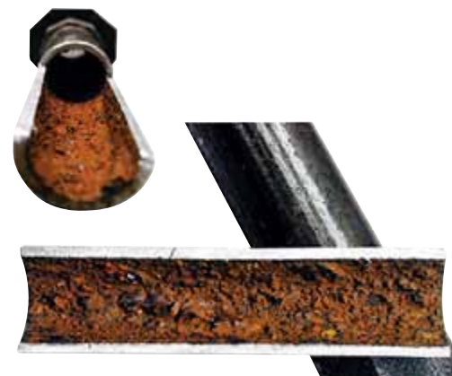
Corte em tubo preto de ar comprimido: contaminação típica.
